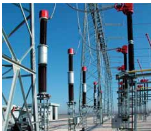
3. Transformateurs inductifs de tension de 420 kV. Rede Eléctrica Nacional (Portugal).
